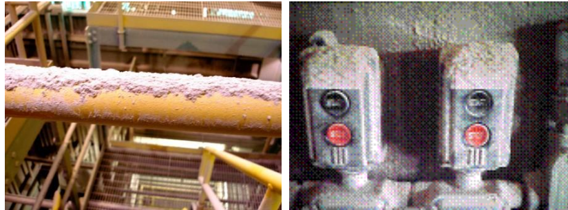
Figura 6. Localizaciones con posible presencia de polvo combustible
