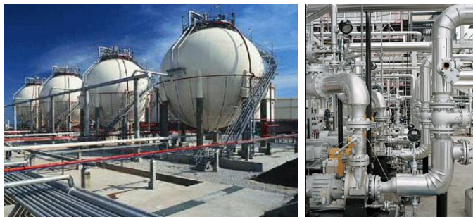
Figura 5. Localizaciones con posible presencia de gas o vapores combustibles.
