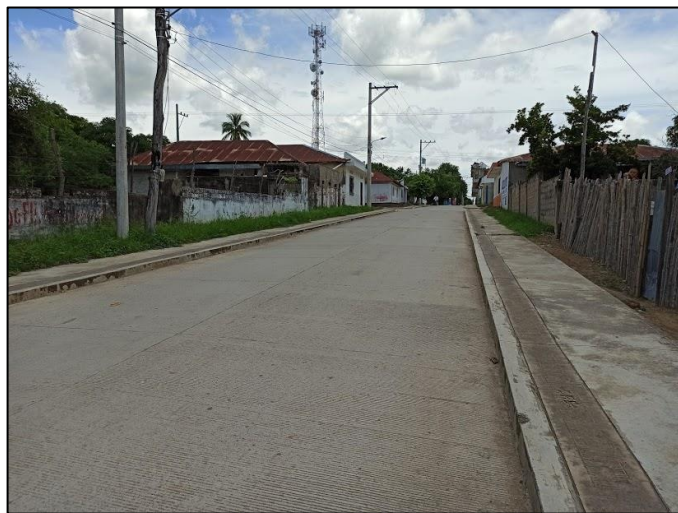
Figura 27. Ausencia resalto carrera 2 Astrea.
