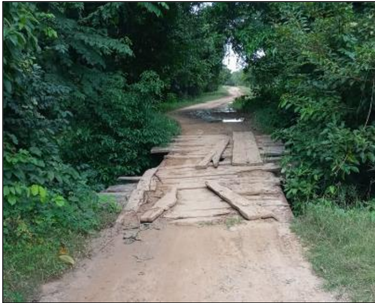
Figura 20. Puente en madera en mal estado.
