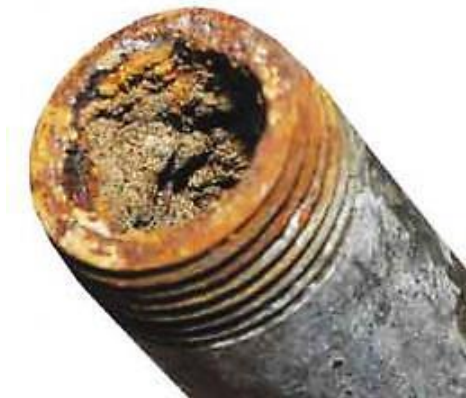
Figura 16. Corrosión galvánica con depósitos de plomo en línea de producción.
