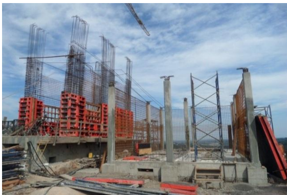
Casetas de subestación Agosto
