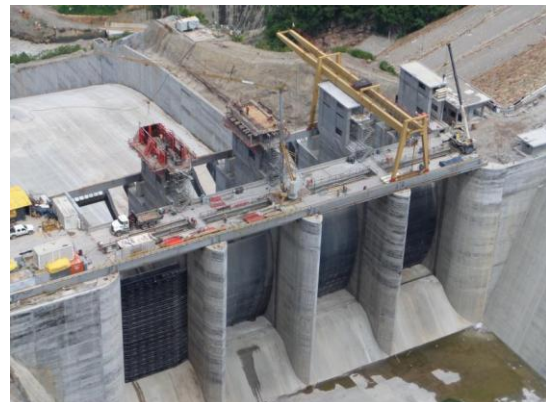
Casetas de operación Octubre
