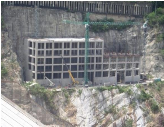
Estructura de Captación - Julio
