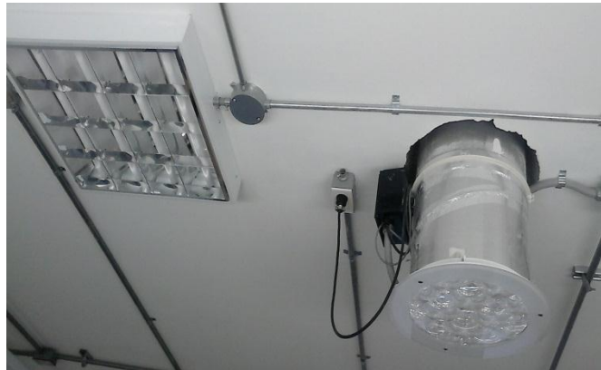
Figura 40. Tubo solar del aula 402 del Edificio de Ingeniería Eléctrica.
