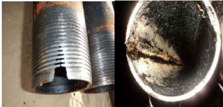
Figura 23. Falla ocasionada por el contacto entre el Tubing y el Rod-tubing.
