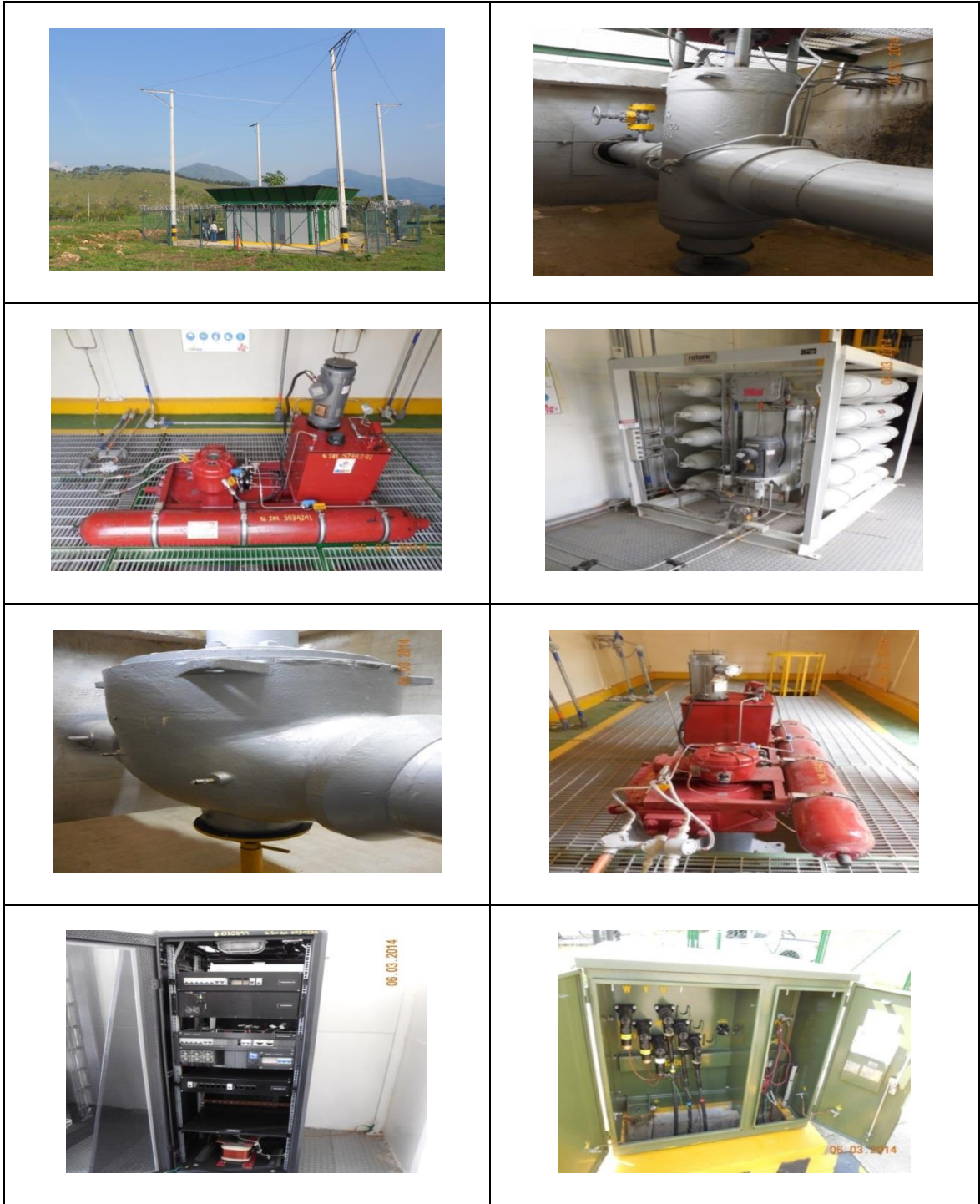
Figura 27. Disposición de Válvulas con operación remota OCLC
