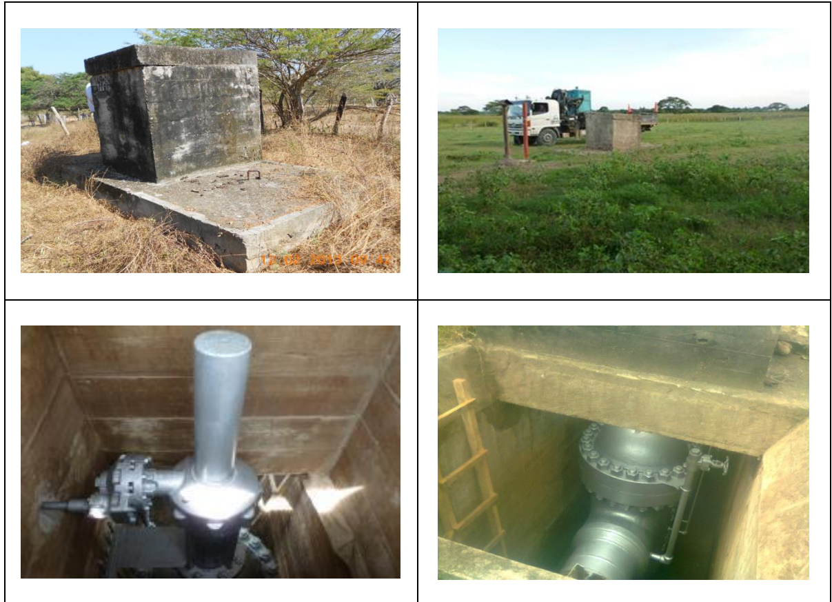
Figura 26. Disposición de Válvulas de compuerta manual OCLC
