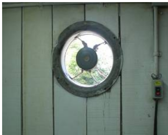
Figura 53. Extractores en guarnición
