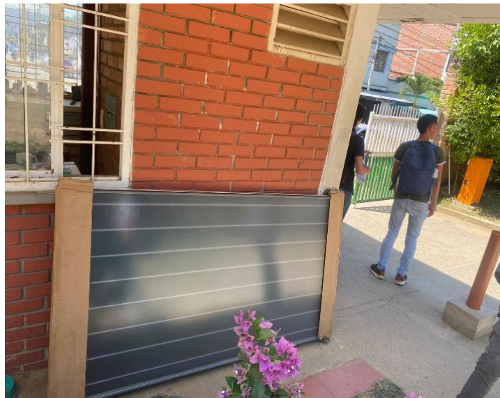
FIGURA 11. Ingreso del colector solar de placa plana.
