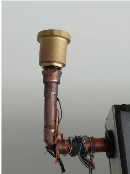
FIGURA 19. Entrada de válvula de seguridad o ventosa.
