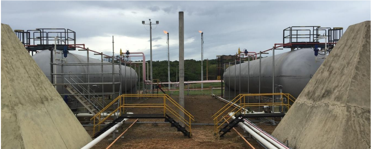
Figura 4: Tanques de Almacenamiento del Cargadero GLP
