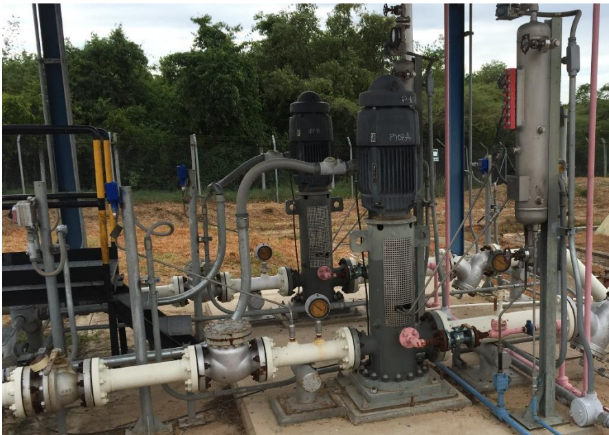
Figura 5: Bombas Centrifugas Multietapa Cargadero de GLP
