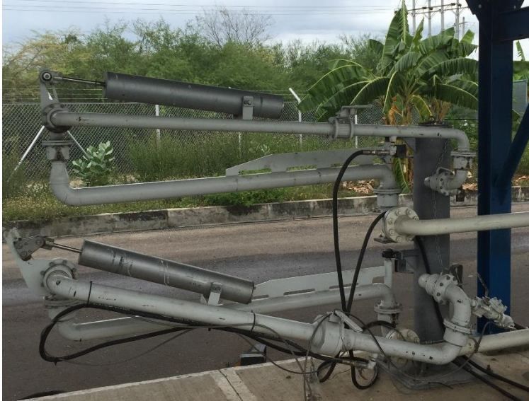
Figura 6: Tren de cargue del Cargadero GLP
