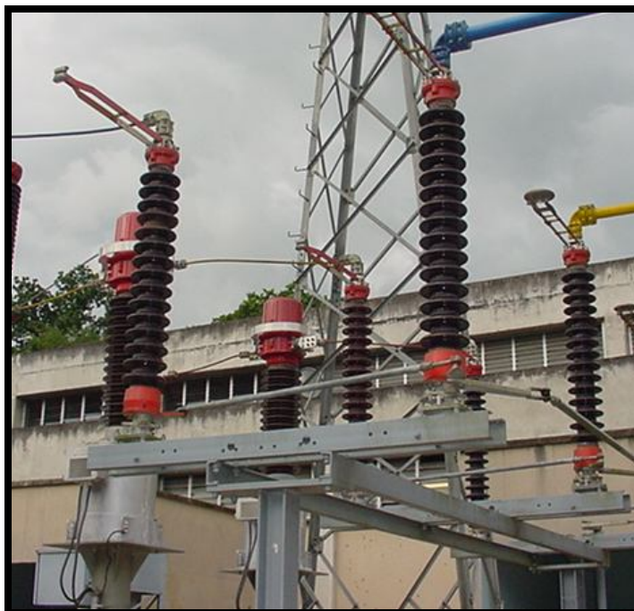
Figura 75: Seccionador de potencia
