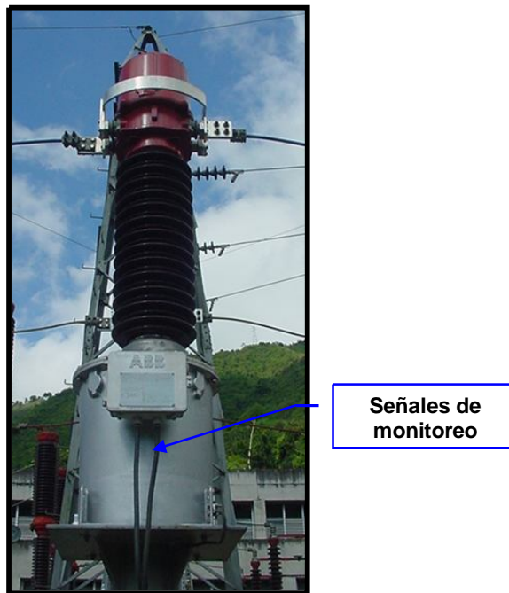
Figura 71: Transformador de corriente
