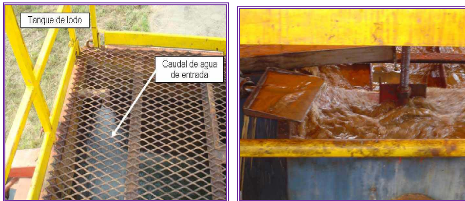
Foto 4. Motores de agitadores, Aspas Tanque de lodo.
