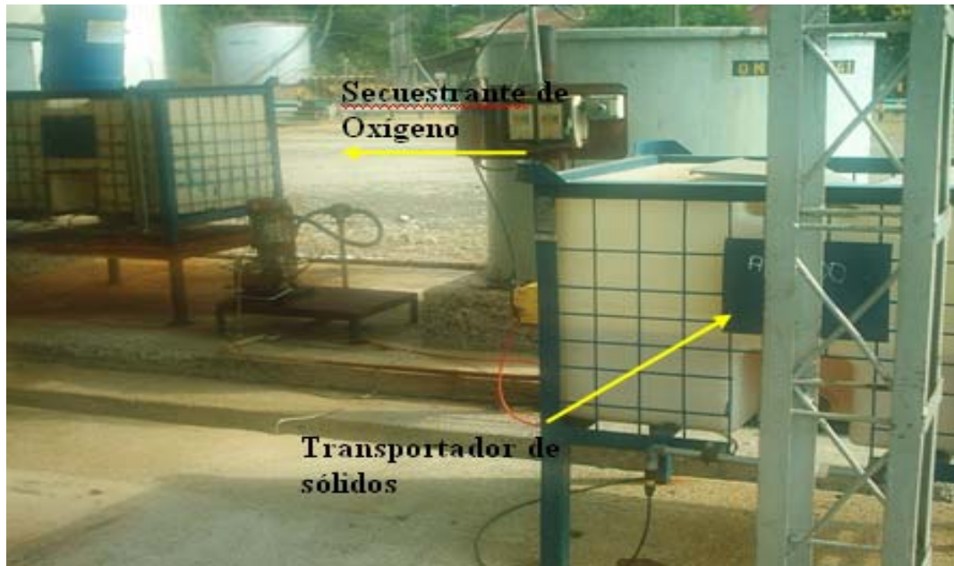
Figura 16. Tanques de inyección de químicos en la planta de tratamiento
