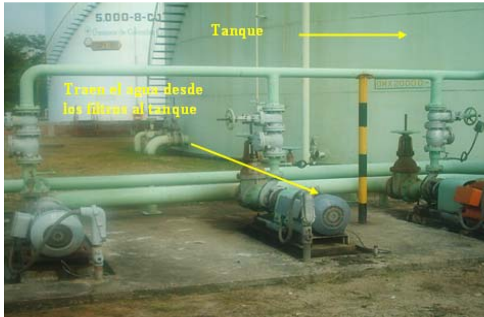
Figura 14. Bombas para la succión al tanque 20.000
