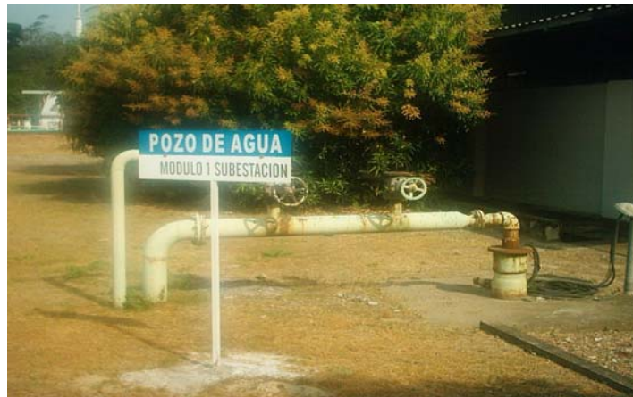
Figura 12. Pozo de captación de agua
