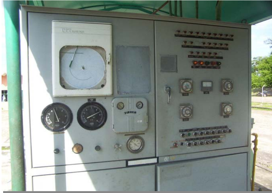
Figura 24. Tablero de control
