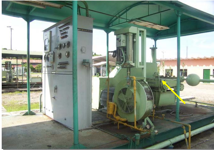
Figura 25. Bomba para agua de alimentación
