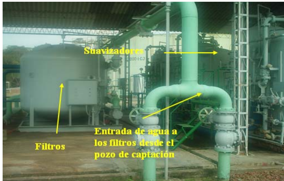
Figura 13. Planta de Tratamiento del agua
