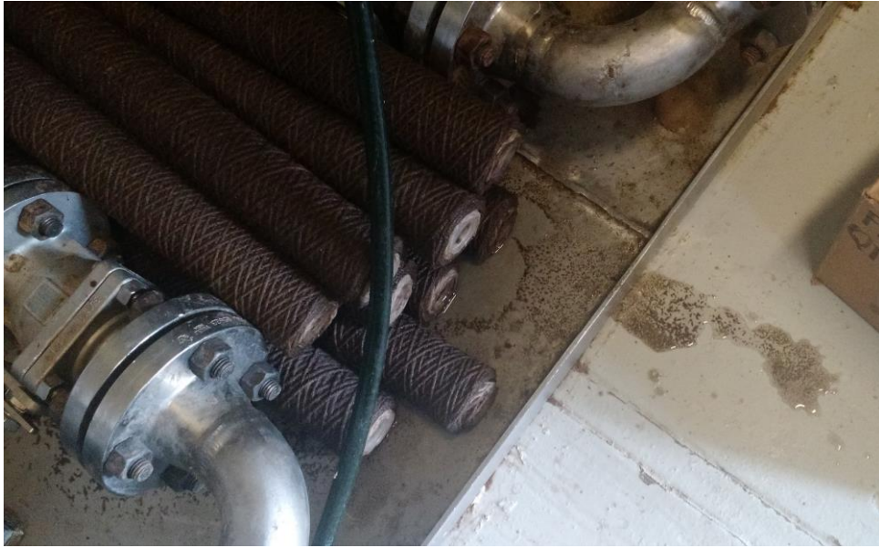
Figura 66. Elementos filtrantes de Filtros de agua.
