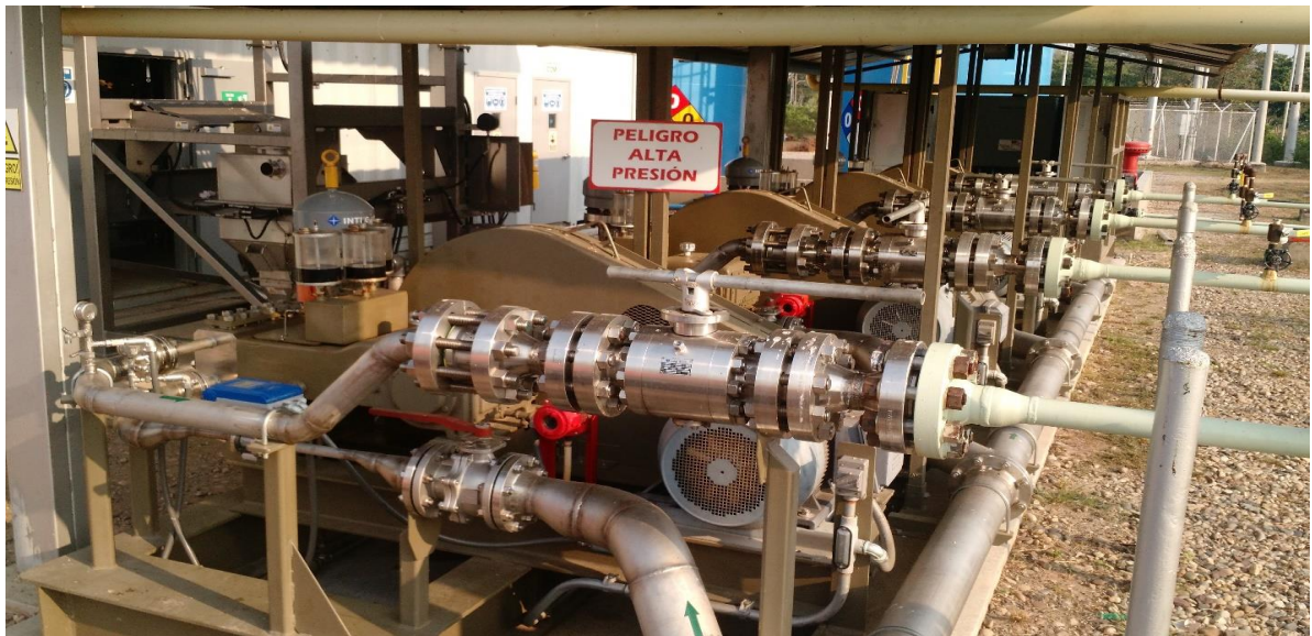
Figura 30. Patín de Bombas de Inyección.
