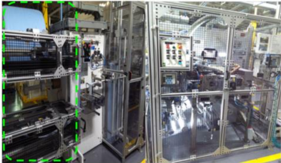
Figura 27. Ubicación del Desenrollador en el Módulo Surge.
