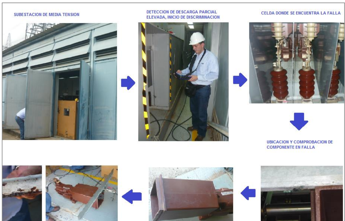
Figura 38. Ubicación de falla a través de Descargas Parciales
