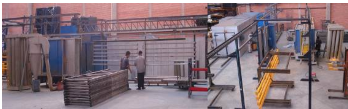
Figura No. 36 Centro de pintura. Cabinas y Horno.
