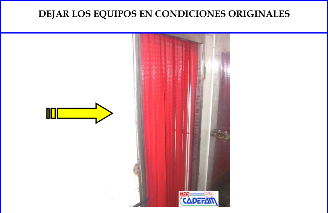
Figura 20. Falta de sustitución de elementos de los equipos.
