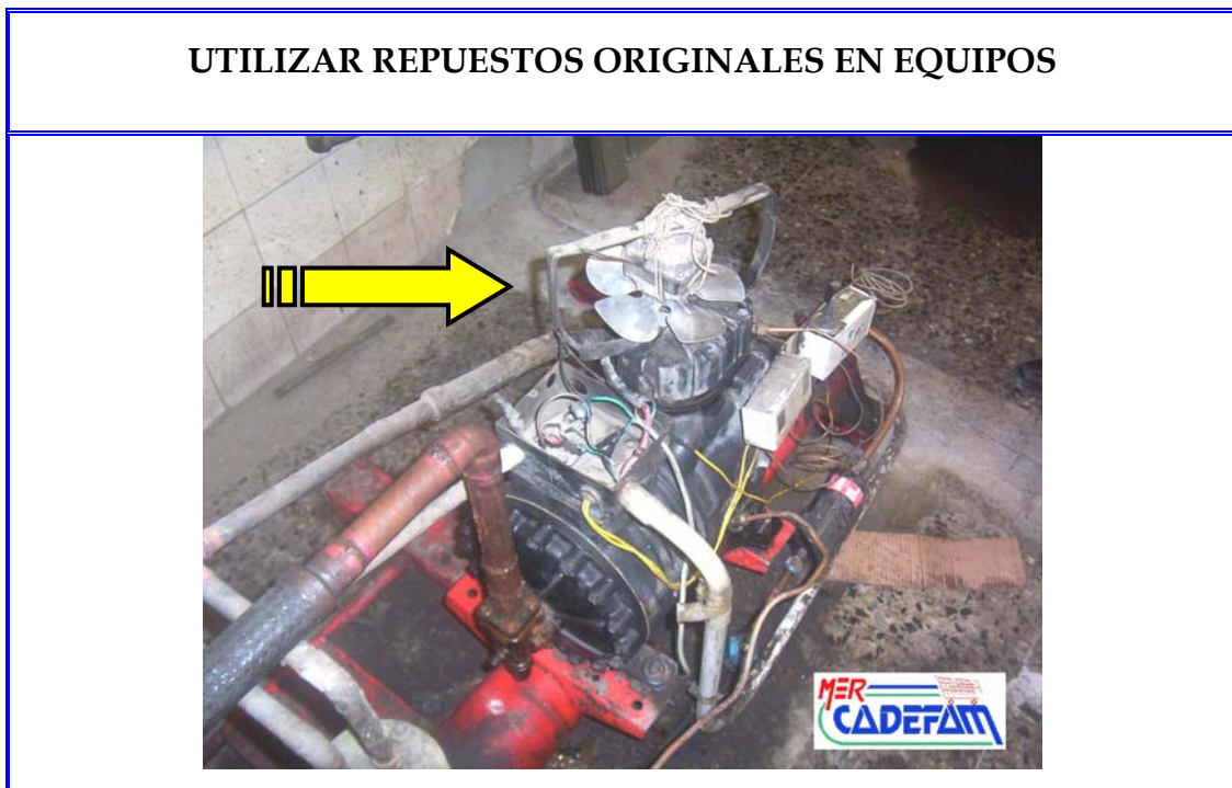
Figura 15. Utilización inadecuada de repuestos.
