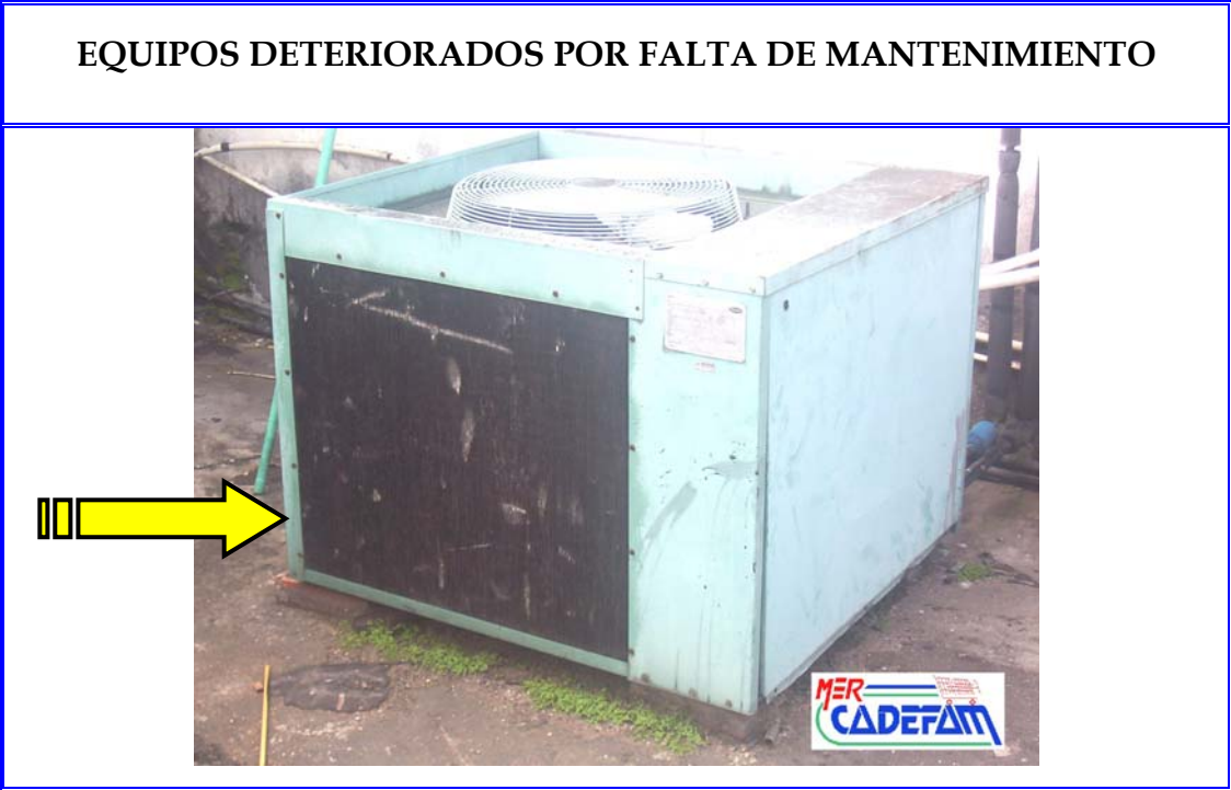
Figura 19. Deterioro de los equipos de aires acondicionados.
