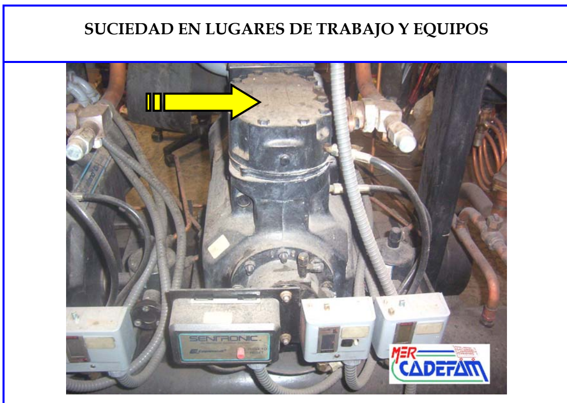
Figura 14. Suciedad excesiva en los equipos.
