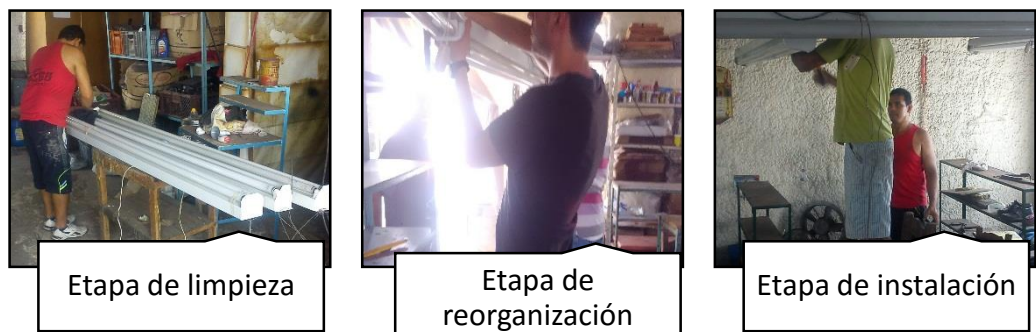
Figura 42. Reorganización de instalaciones luminosas.
