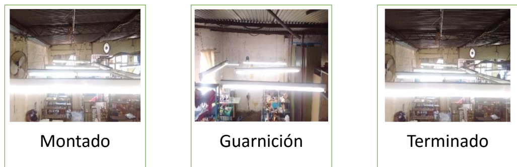
Figura 21. Ubicación de la iluminación.
