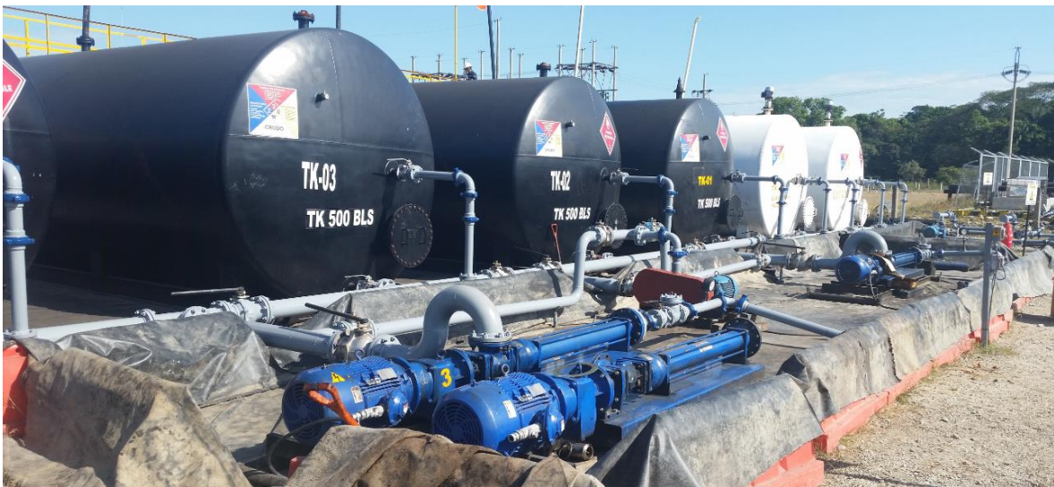
Figura 12. Bombas de tornillo.
