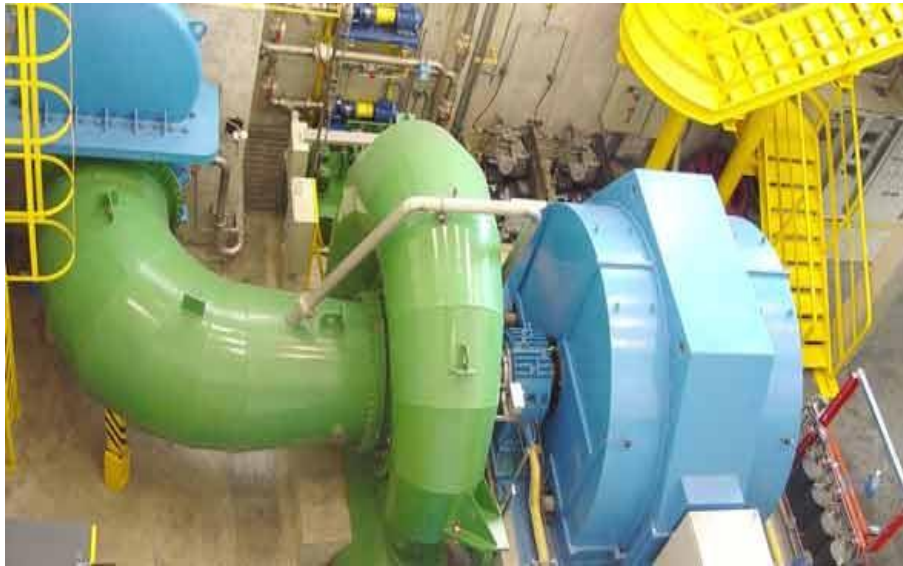
Figura 3. Central Hidroeléctrica de Santa Ana.
