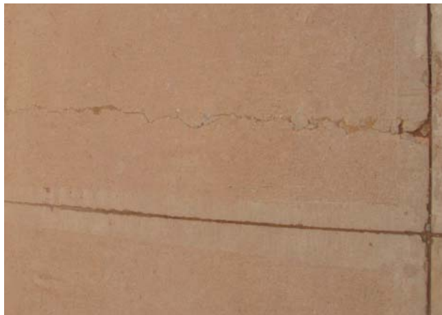
Figura 49. Detalle fisuras aparecidas en las losas.
