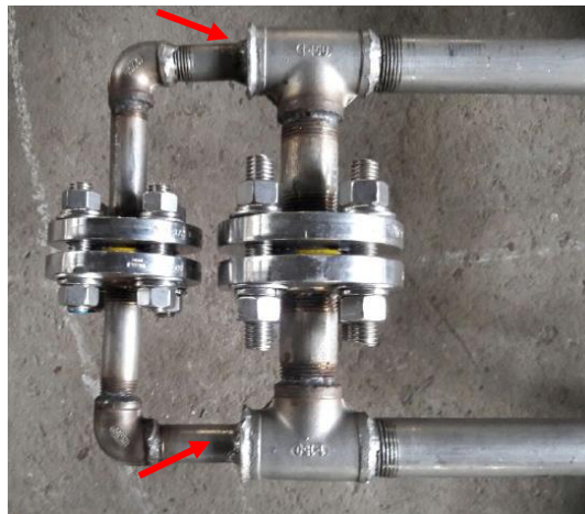
Figura 28. Conexiones T modificadas y unión de tramos con bridas.
