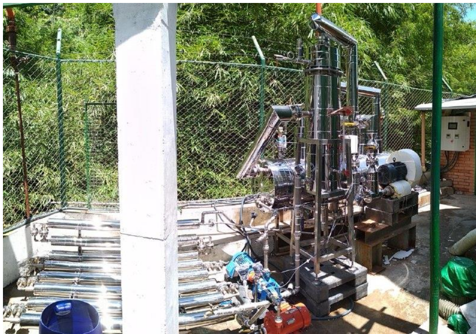
Figura 12. Ensamble completo del sistema de destilación mecánica de vapor en la planta de beneficio de Floridablanca.
