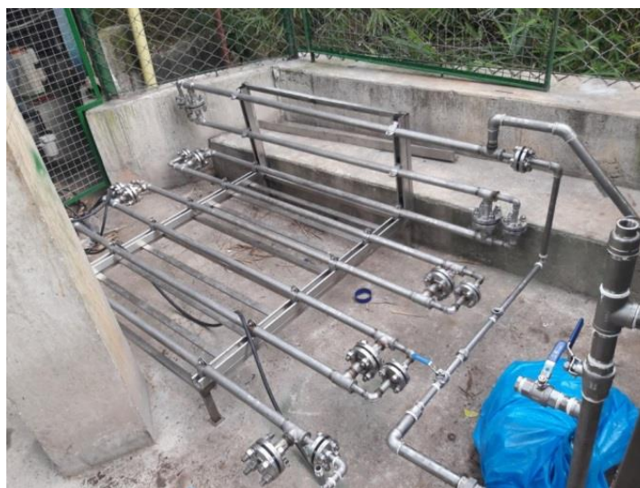
Figura 30. Economizador construido, ya instalado en la planta de beneficio de Macpollo
