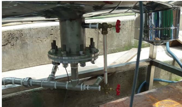
Figura 20. Mirilla de nivel de condensado.
