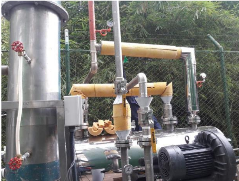
Figura 34. Aislamiento de fibra de vidrio usado en todo el sistema de destilación.
