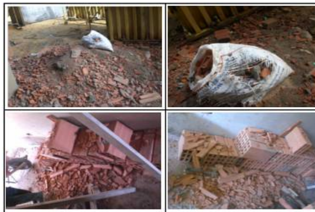
Figura 4. Escombros de mampostería.
