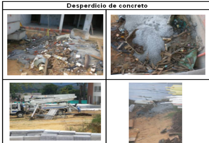
Figura 19. Desperdicio de concreto.
