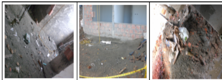
Figura 13. Escombros generados en el friso.
