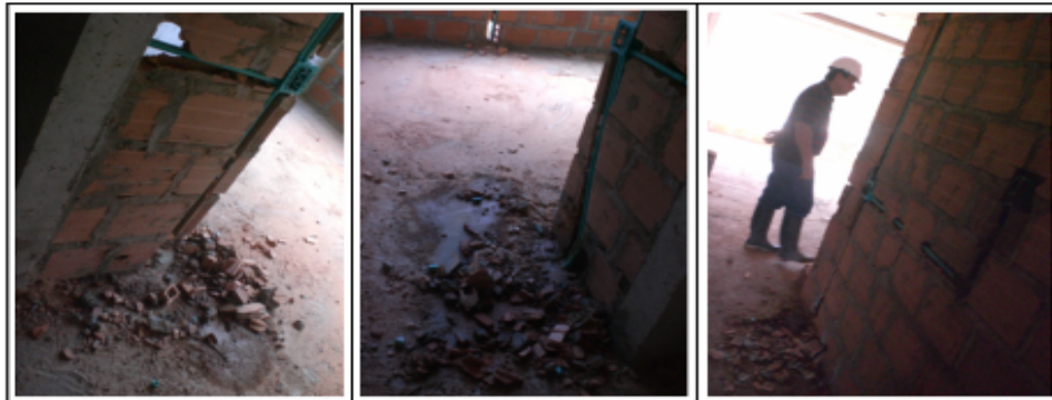
Figura 3. Escombros de mampostería generado por las regatas eléctricas.
