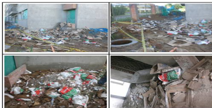
Figura 29. Desaseo generado por el proceso de pisos y enchapes.
