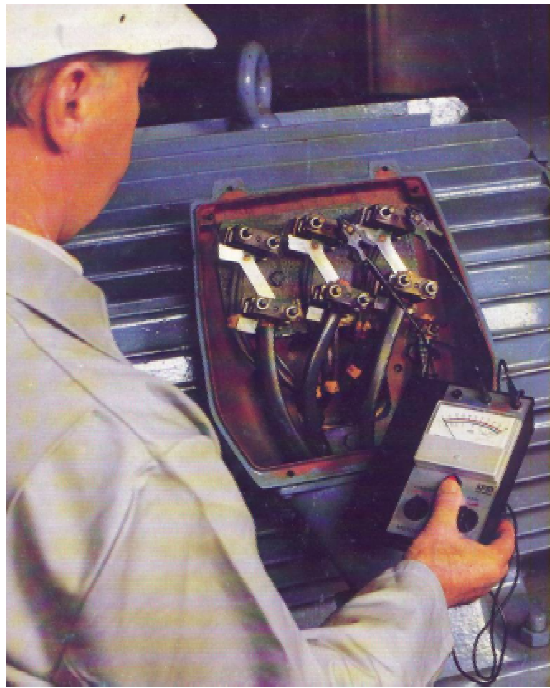
Figura 186. Medición de voltajes
