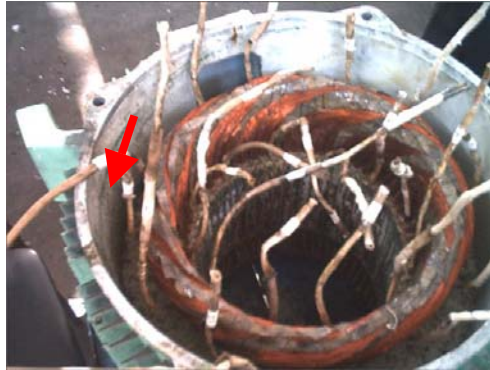
Figura 184. Malas conexiones del devanado
