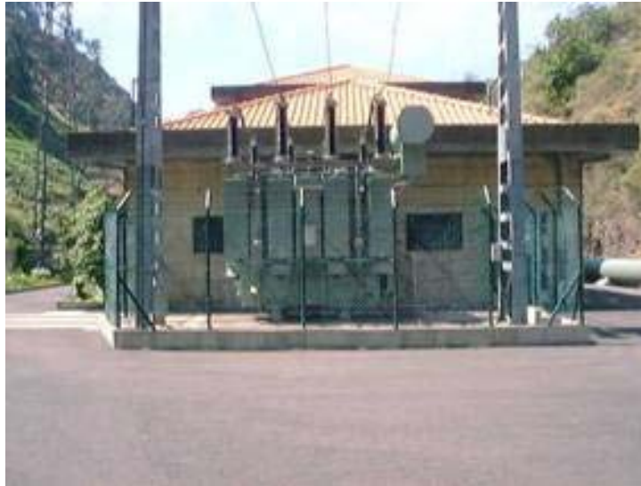
Figura 199. Transformador de Potencia en baño de aceite y refrigerados por circulación natural del aire.
