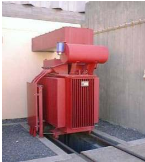
Figura 198. Transformador de Potencia
