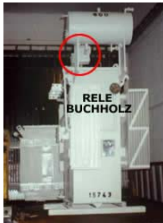
Figura 224. Relé de protección del cambiador de tomas bajo carga
