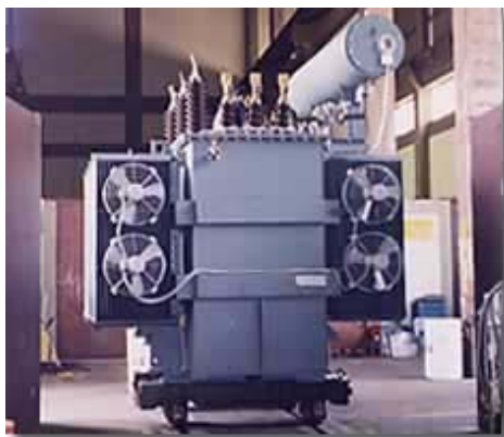
Figura 200. Transformador de Potencia en baño de aceite y refrigerados por circulación forzada del aire
