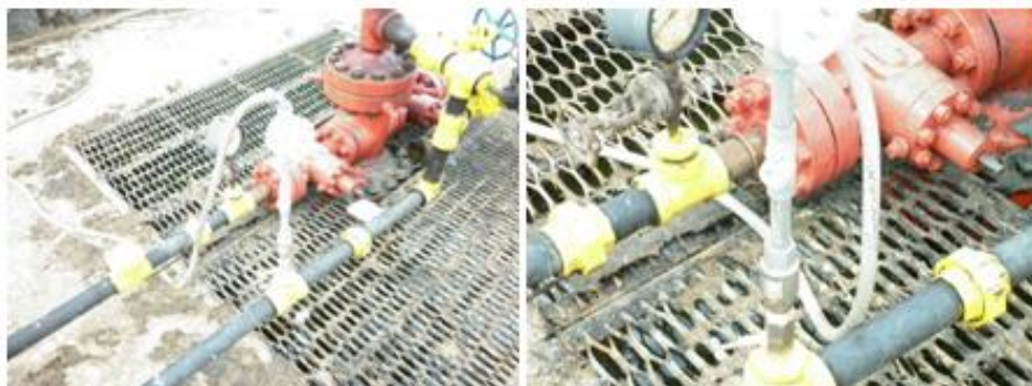
Figura 10. Sensor de presión instalado en líneas de salida de la tubería de producción
