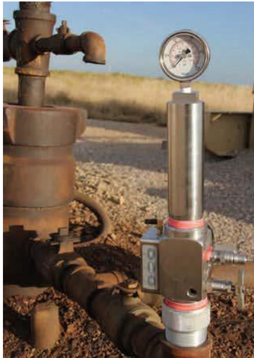
Figura 60. Sensor de nivel y presión instalado en línea de casing
