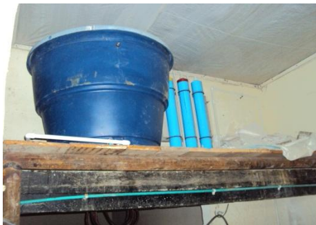
Foto 2. Tratamiento de Agua Potable
