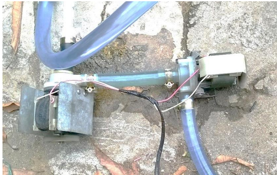
Figura 19. Montaje de bombas en serie
