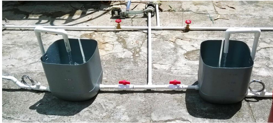
Figura 18. Sistema de bombeo
