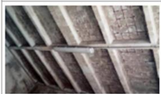
Se recomienda resarar techo de la subestación eléctrica
