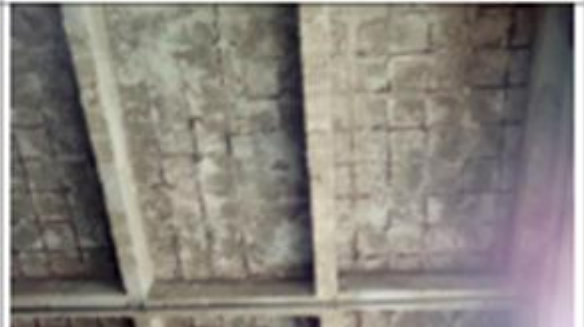
Se caen pedazos de loza solos, en caso de lluvia se pueden presentar filtraciones de agua.
