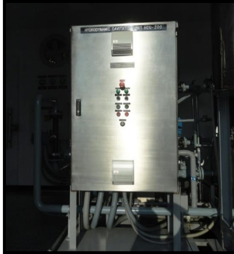
Figura 14. PLC. Fuente: ERVS. S.A.S.
