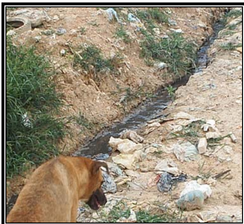
Foto 3. Canal de Fluído de Lixiviados
