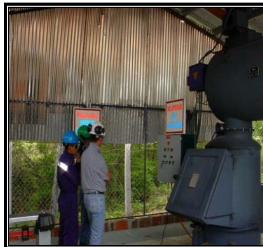
Foto 33. Incinerador en planta
