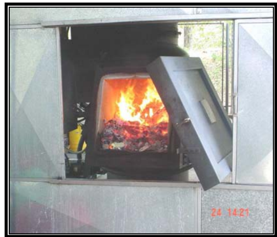
Foto 29. Incinerador en funcionamiento
