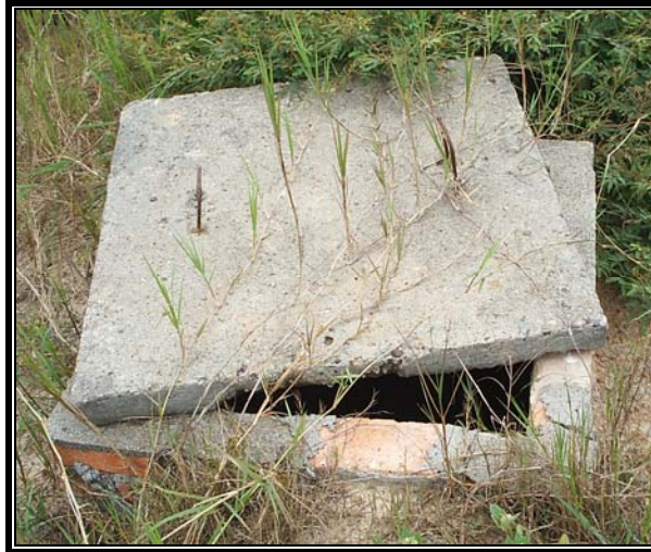
Foto 8. Tanque de Aguas Subterráneas
