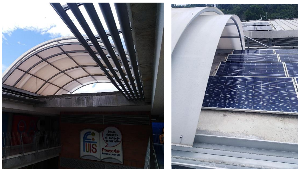
Fotografía 12. Sombreado en los paneles a causa de un domo contiguo.
