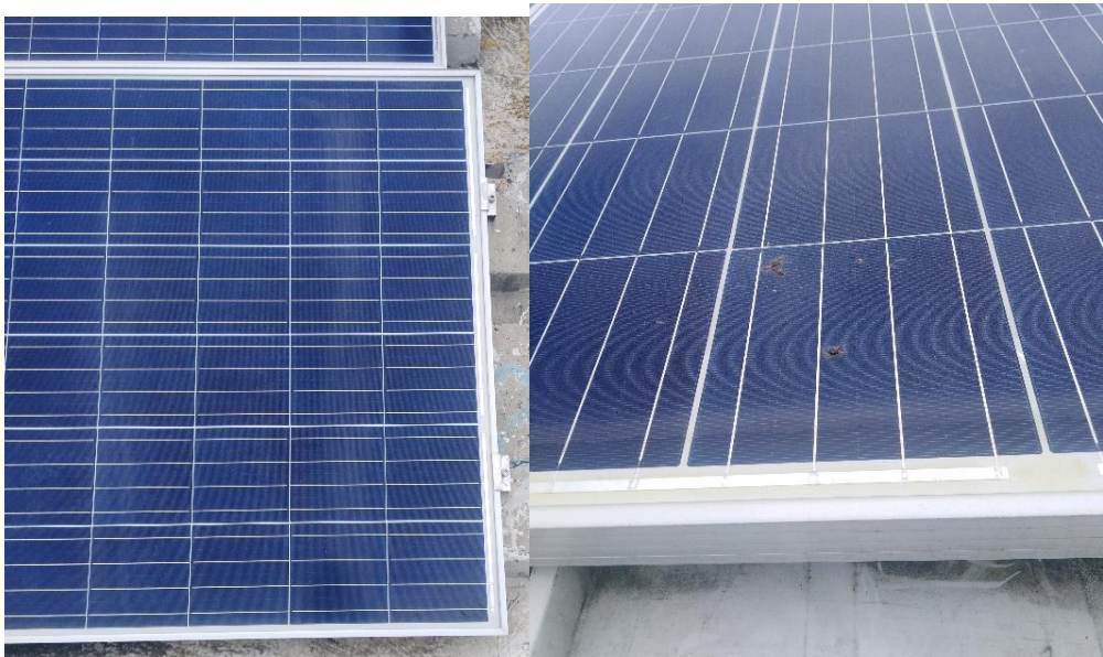
Fotografía 13. Malas condiciones de aseo sobre la superficie de los paneles (restos de jabón y heces de aves).
