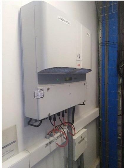
Fotografía 7. Inversor trifásico ON GRID 10/12.5 kW ABB.
