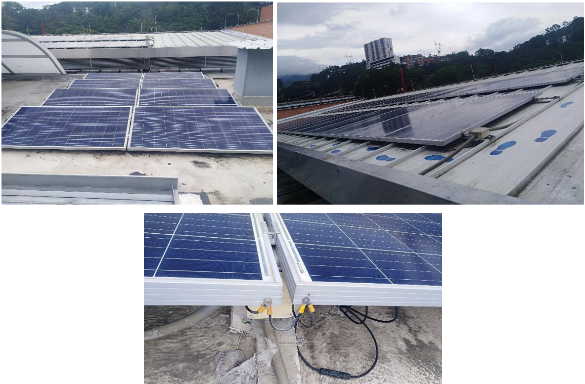
Fotografía 6. Arreglo de los 32 paneles solares del sistema fotovoltaico en la institución.
