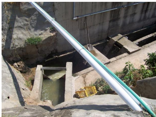
Figura 80. Sistema de cribado de la planta de tratamiento EPAMSGIR.
