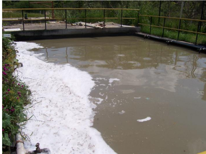
Figura 83. Tanque de aireación de la planta de tratamiento EPAMSGIR.
