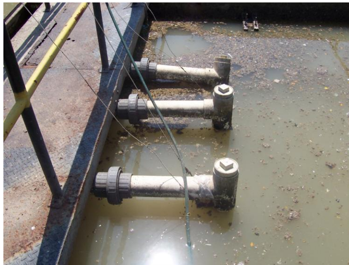
Figura 86. Tanque de sedimentación.
