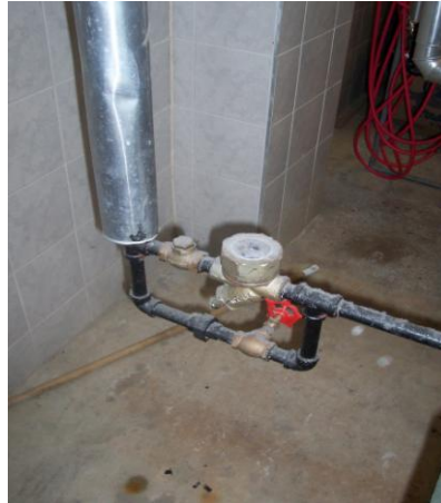
Figura 29. Estación reguladora de condensados.
