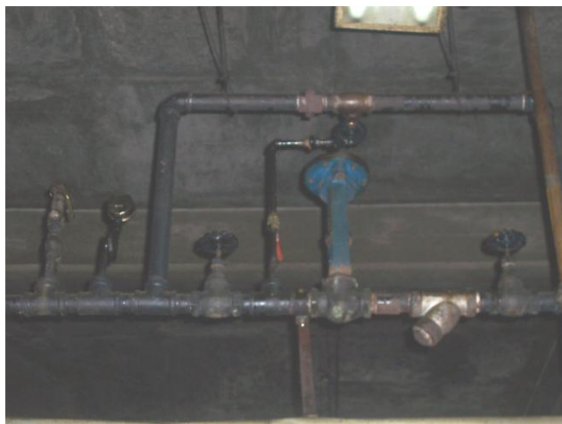
Figura 28. Estación reguladora de vapor para marmitas.
