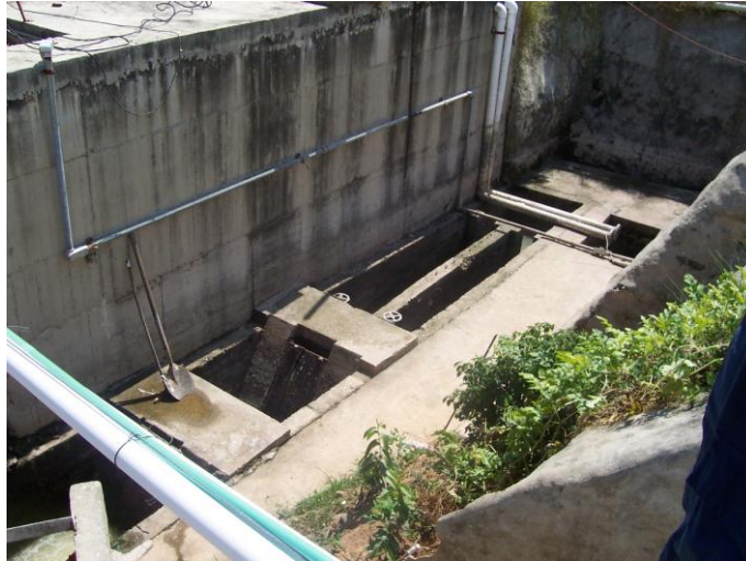
Figura 82. Tanque de igualación nueva de la planta de tratamiento EPAMSGIR.
