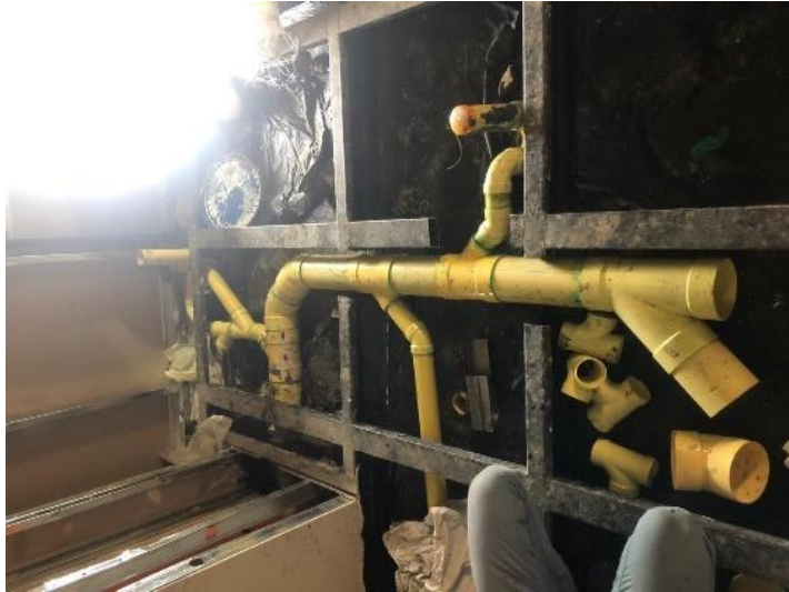
Figura 13. Tubería de desagüe
