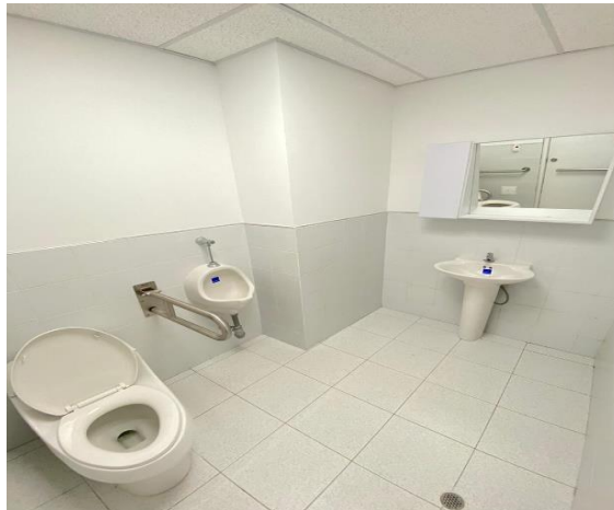
Figura 19. Instalación sanitaria, orinal y lavamanos
