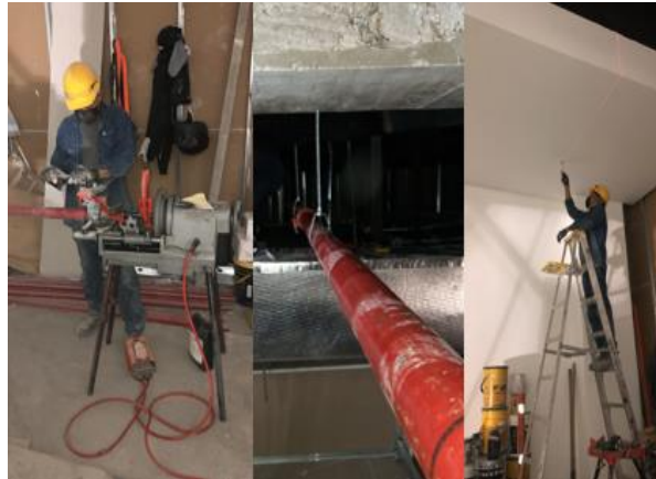
Figura 21. Red contra incendios
