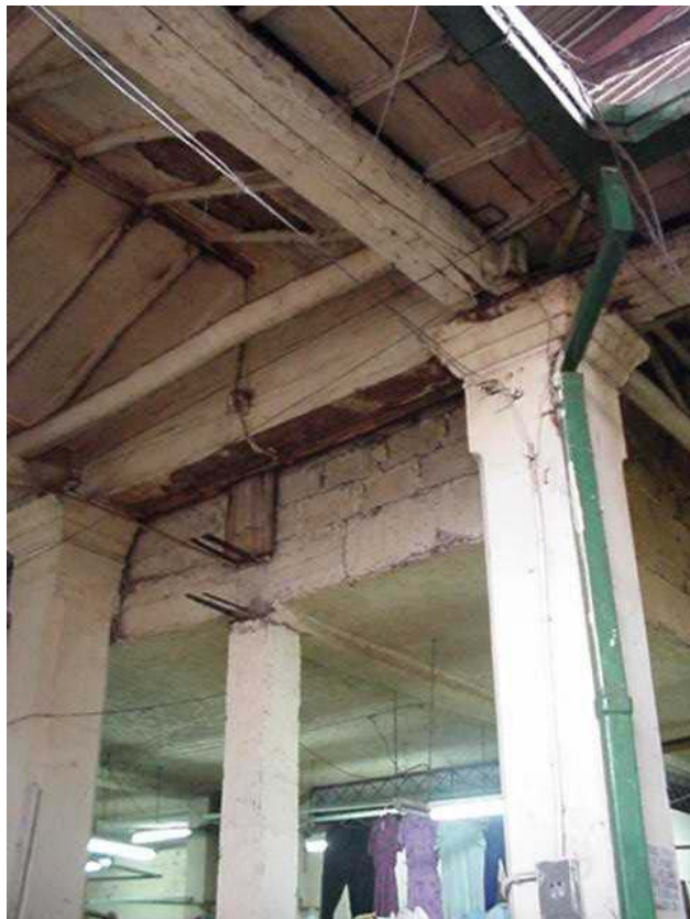
IMAGEN 16. Estado de techos y columnas de la plaza de mercado
