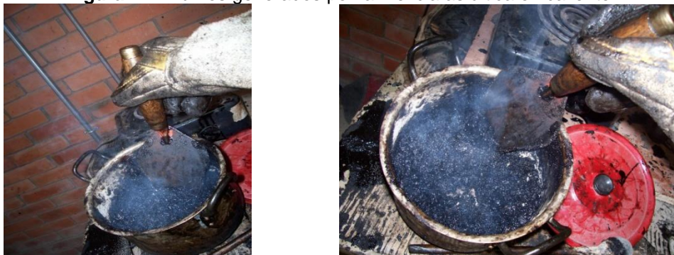
Figura 2.1. Humos generados por la mezcla asfáltica en caliente.
