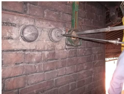
Figura 19. Adecuación de la sonda del analizador de gases LANCOM en la chimenea
