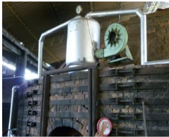
Figura 47. Sistema de aire de un OVERFIRE-AIR
