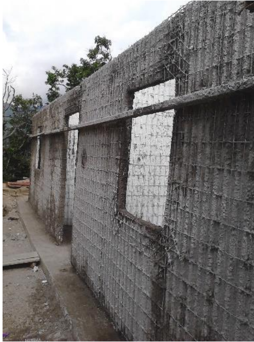
Figura 16. Vivienda tipo 2 después del chafarreo.
