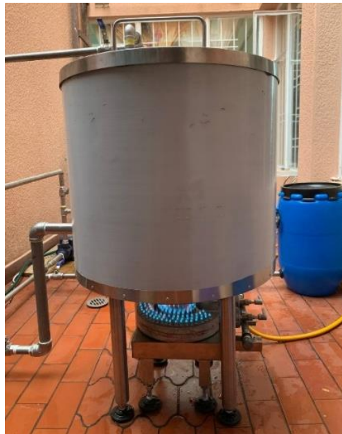
Figura 60. Encendido del quemador
