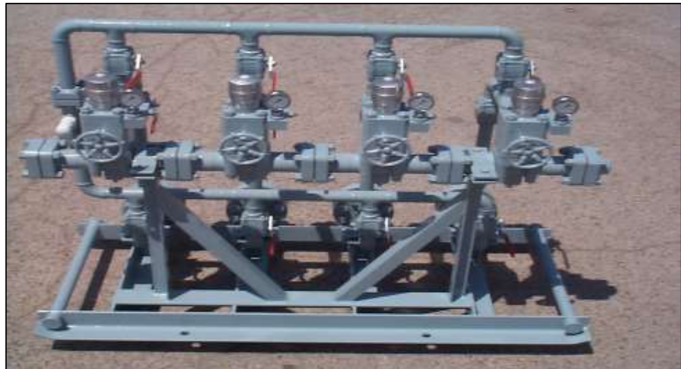
Figura 19: Manifold de distribución del fluido de potencia
