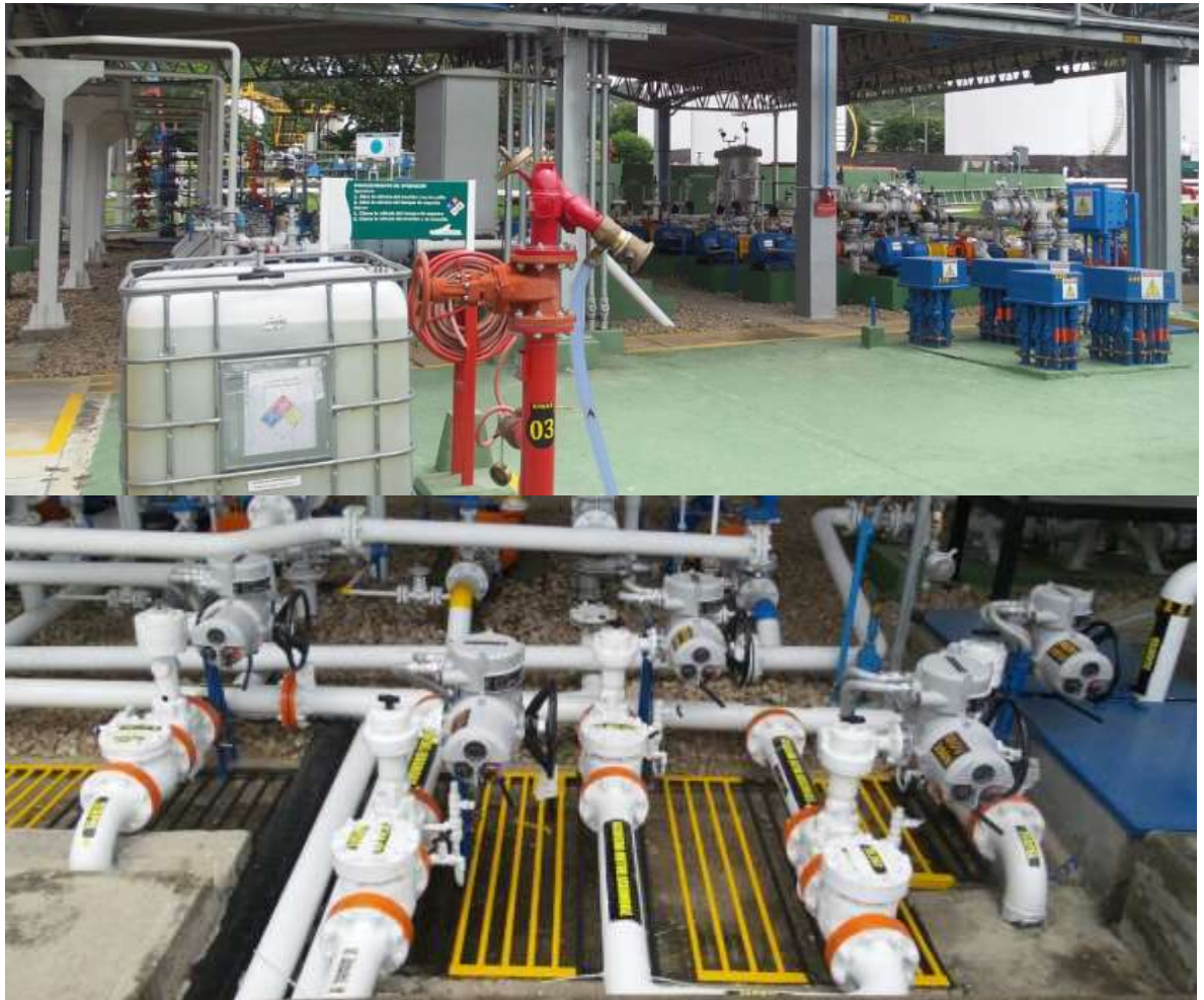
(b) Equipos involucrados en el transporte de hidrocarburos.
