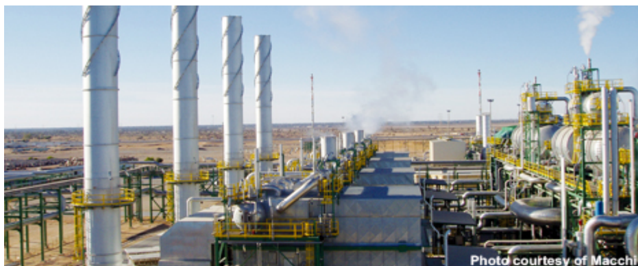
Figura 1 Central eléctrica a gas
