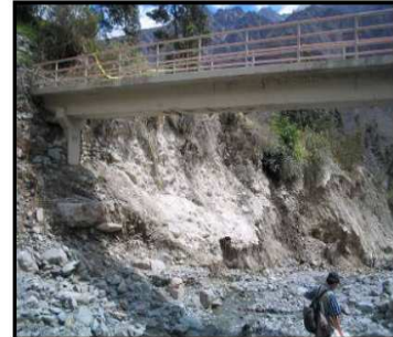
Foto 2. Puente peatonal Tiaparo-Palomar inhabilitado debido a la destrucción de sus pilares.
