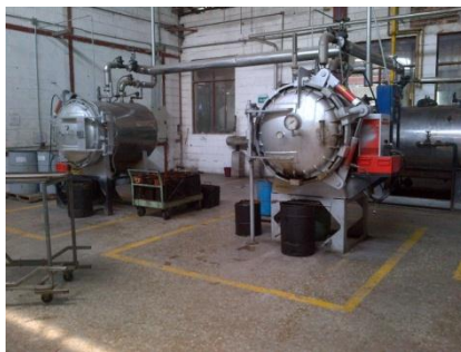
Foto 21. Área de calderas
