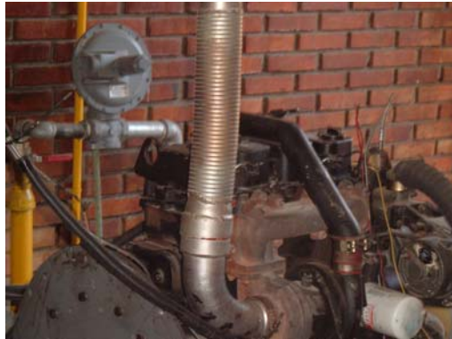
Figura 105. Sistema de Escape
