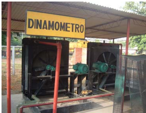
Figura 95. Radiadores de Enfriamiento.
