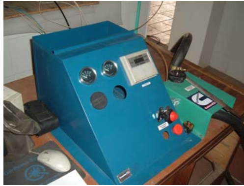
Figura 107. Consola de Control.
