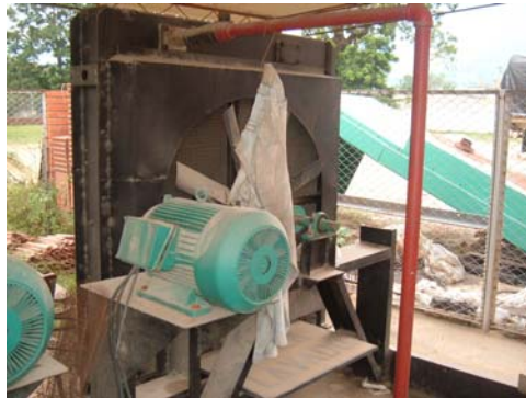
Figura 30. Radiador destinado para Refrigeración.
