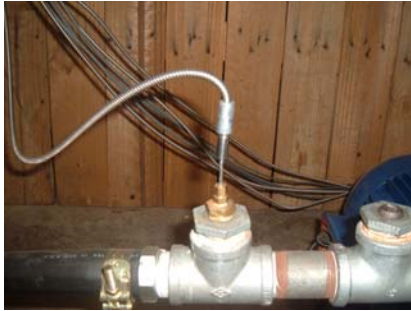
Figura 127. Medición Temperatura Entrada Agua Dinamómetro.
