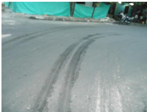
Fotografía 8. Falla en el pavimento
