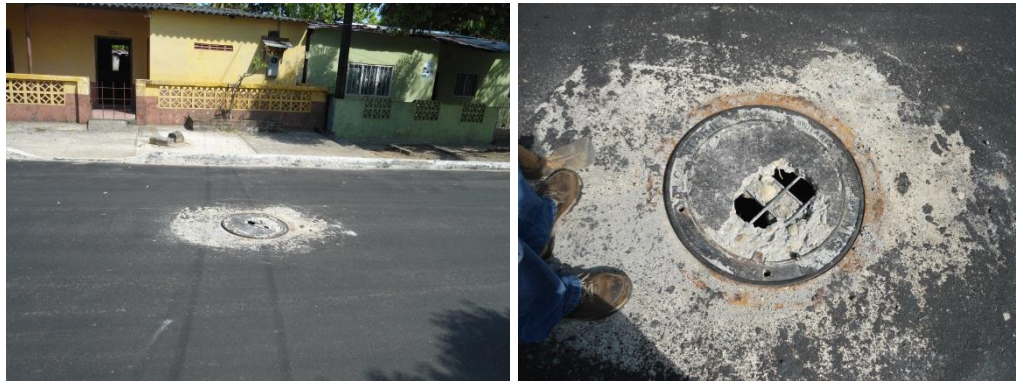
Fotografía 7. Tapa de pozo de inspección en mal estado
