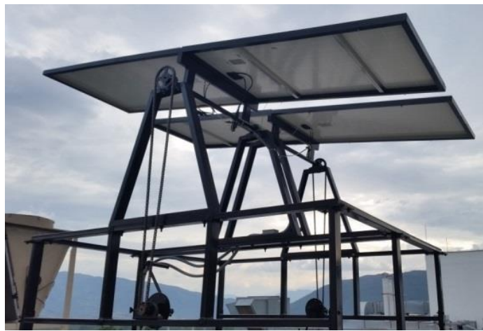
Figura 27. Paneles instalados en el parque tecnológico de Guatiguará
