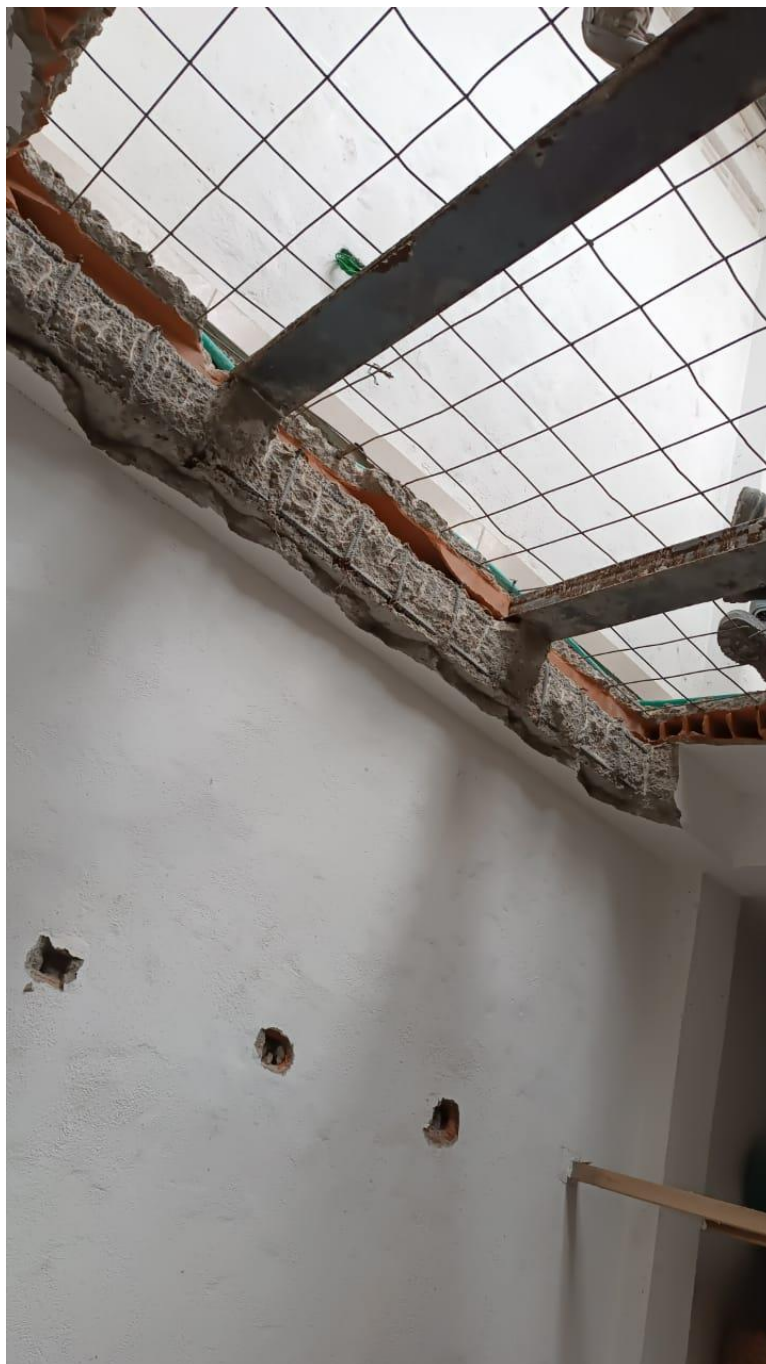
Anexo 11. Abertura hueco en el segundo piso del edificio.
