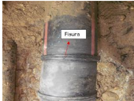
Figura 18 Detalle en fisura sentido circunferencial.
