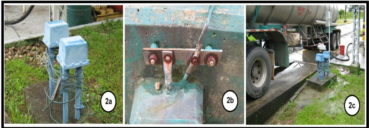
Figura 35. Defectos en la puesta a tierra para vehículos transportadores de combustible
