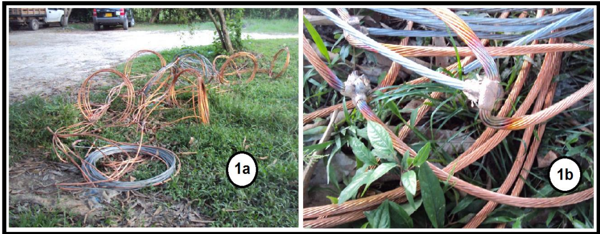
Figura 34. Defectos en la manipulación del conductor de puesta a tierra
