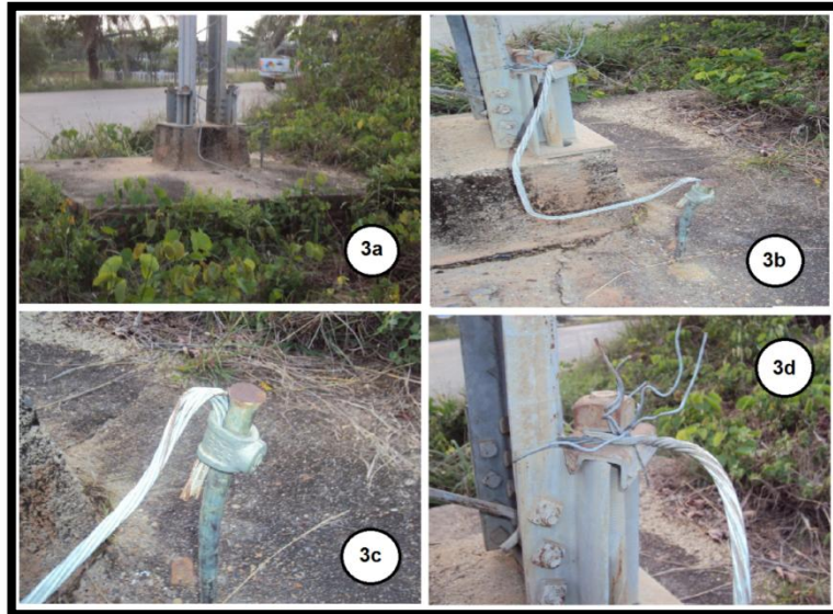
Figura 36. Defectos encontrados en estructura de media tensión
