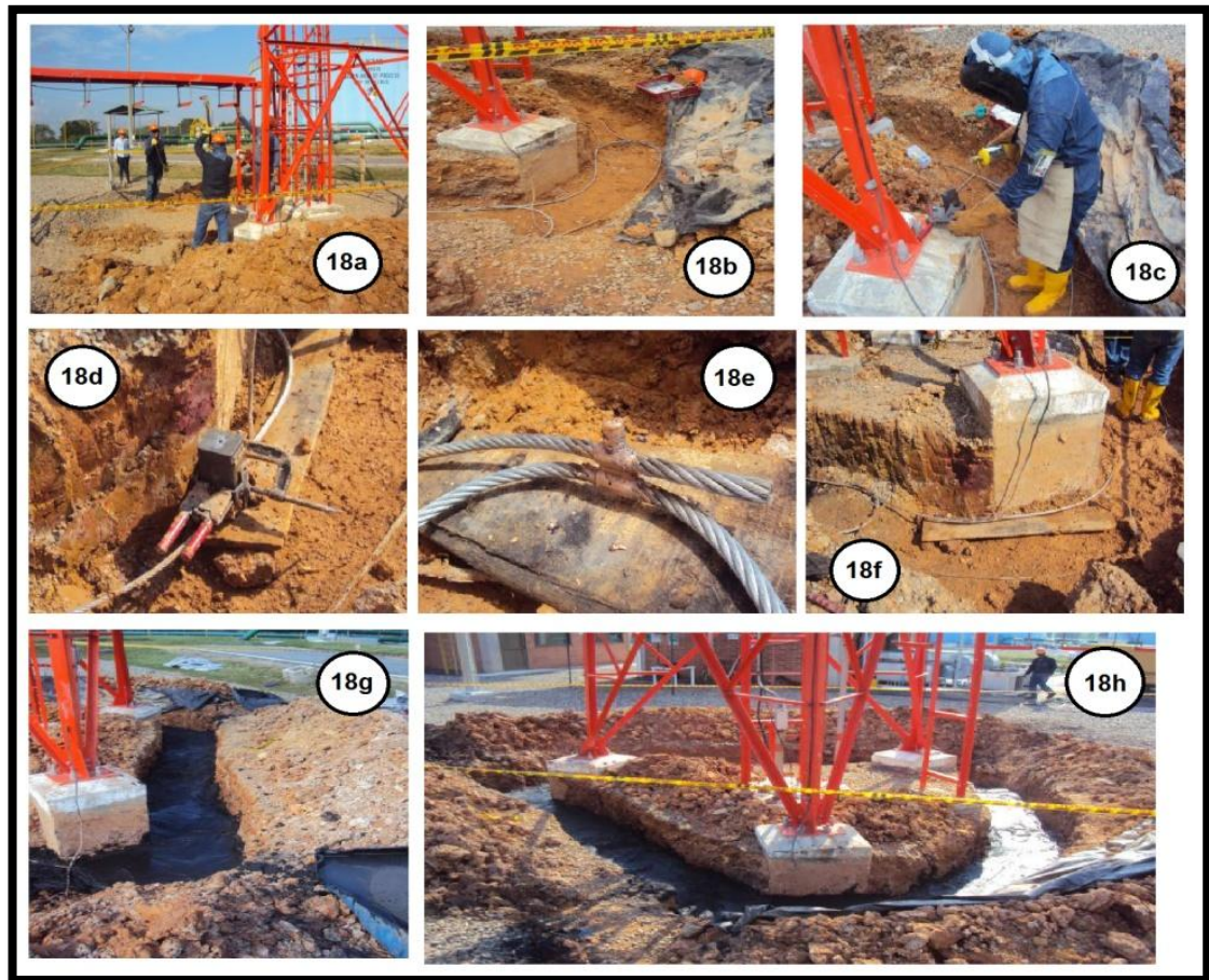
Figura 51. Puesta a tierra para antena de telecomunicaciones
