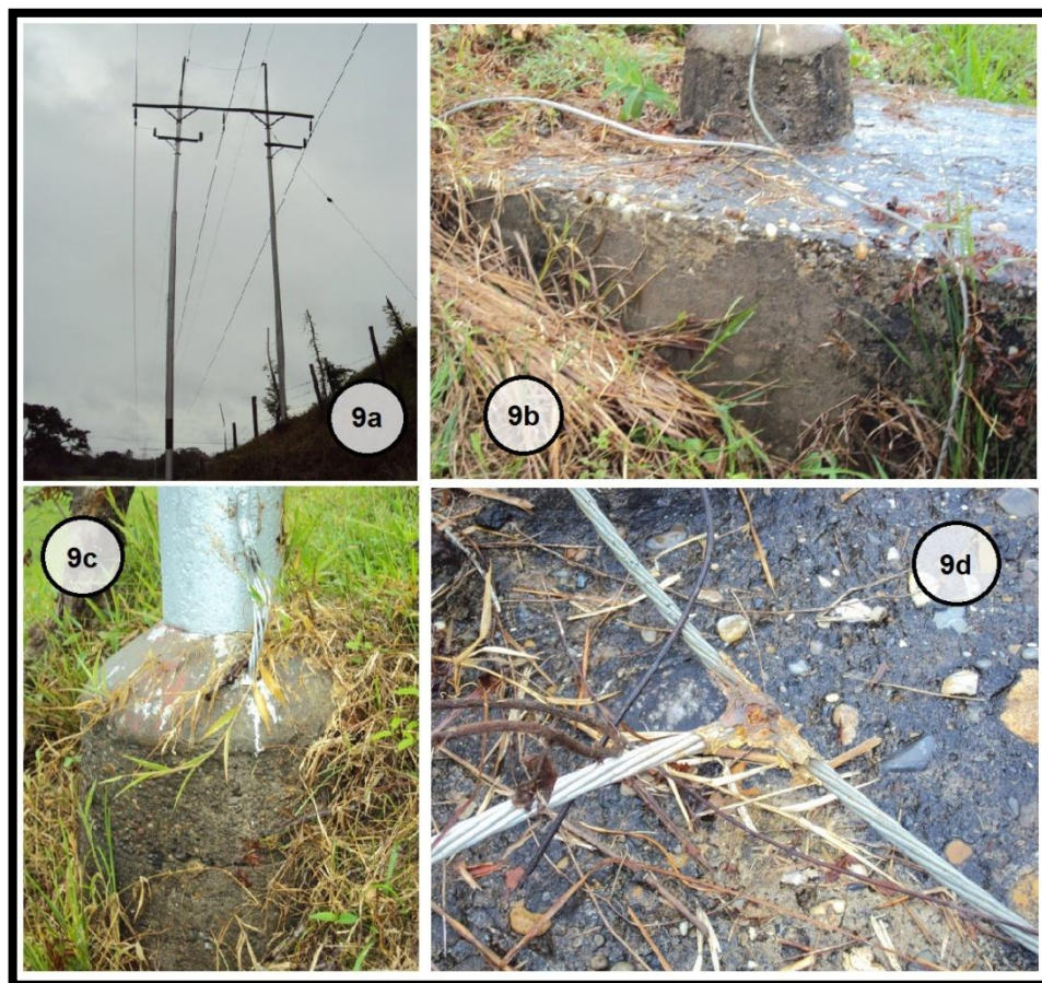
Figura 42. Disposición inadecuada de bajante de puesta a tierra para estructura con DPS
